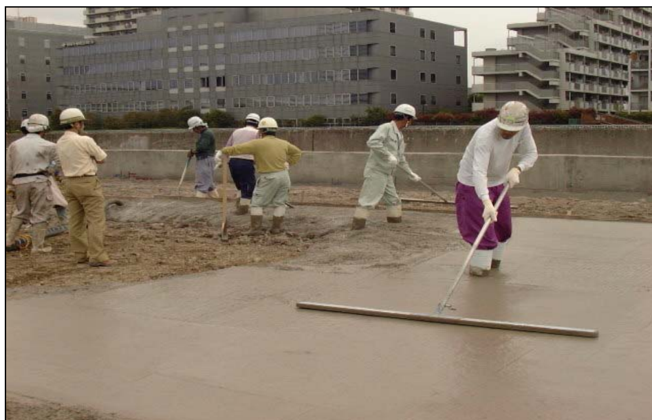
【土壤汚染対策工事用押さえコンクリート(再生骨材コンクリート)打設 実施風景】
