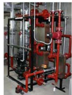
熱交換器と循環パイプ
