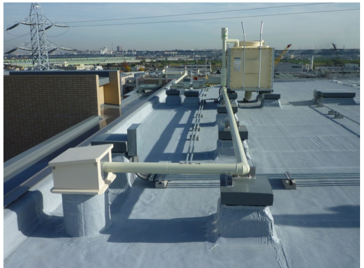
【マンション屋上の「Pボックス」設置状況】
