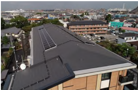
太陽光発電設備 設置風景（屋上）
