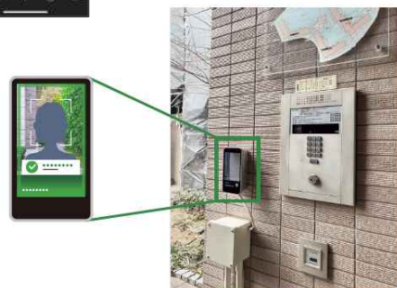
顔認証システム設置エントランス
