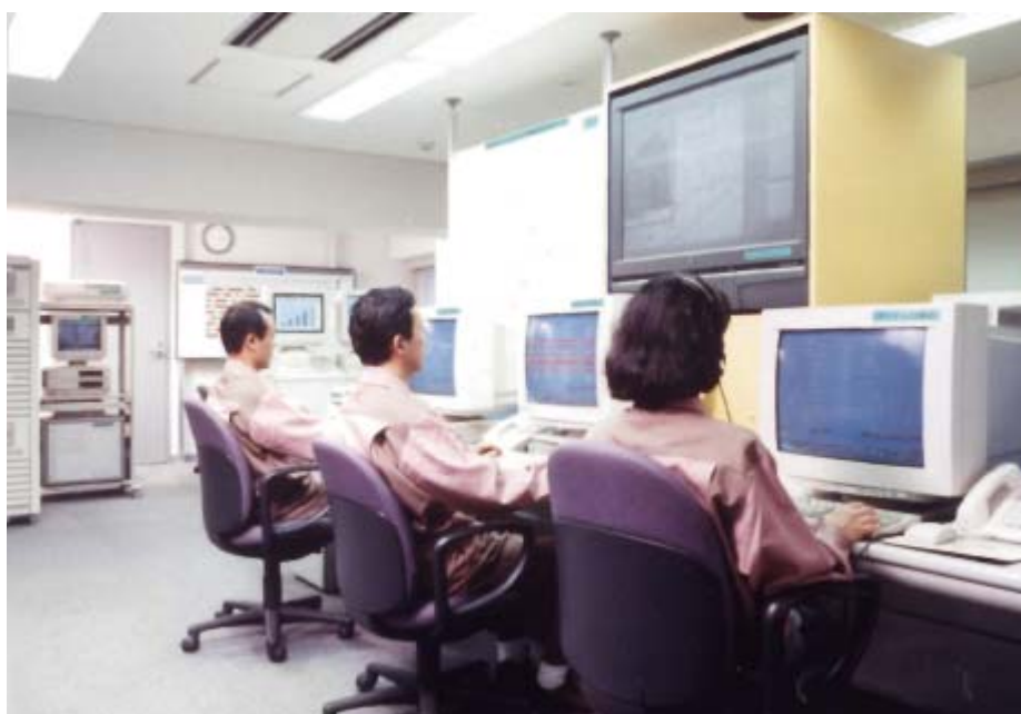
【「アウル24センター」（緊急監視センター）内部】
