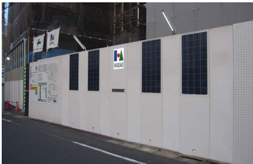
[作業所仮囲いに設置した太陽光発電システム]
