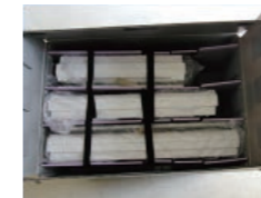
各住戸分電盤の通い箱
