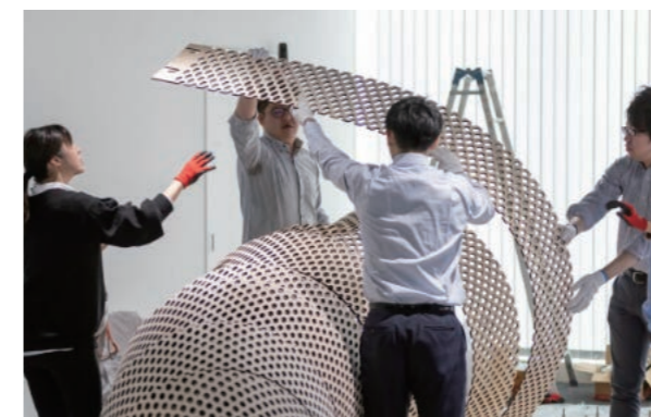
ベニヤ板にあける穴の密度を変化させ、視線透過度・曲げやすさ・弾性を制御する「ウロコシステム」を活用し、ベニヤ板をスパイラル状に連続させてパビリオンを構成
