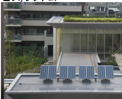
太陽光発電設備
