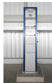
電気自動車充電設備
