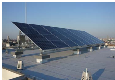
太陽光発電システム
