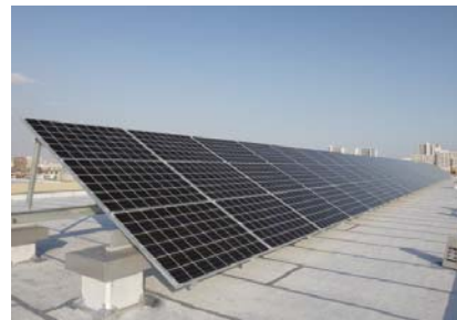
太陽光発電設備
