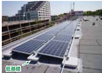
低基礎工法によるソーラーパネル
