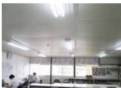
現場事務所にLED照明を採用
